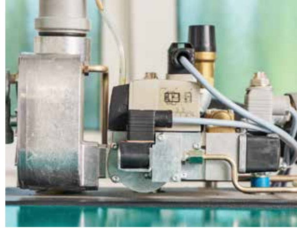
Blockheizkraftwerke funktionieren nach dem Prinzip der Kraft-Wärme-Kopplung.
